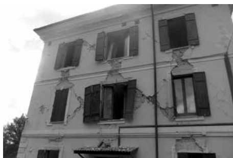
Figura 1.10. Sisma Italia centrale 2016: lesioni da taglio nei maschi murari e nelle fasce di piano (foto A. Lemme)
